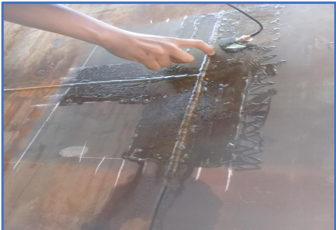
Vista fotográfica N° 12: Area de inspeccion y defecto encontrado
