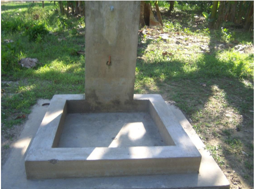
Foto 5. Infraestructura de agua en Moena caño. Deteriorada
