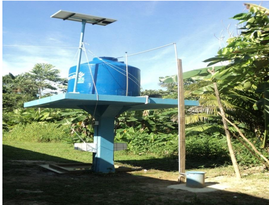
Foto 1. Pozo artesiano en Moena Caño
