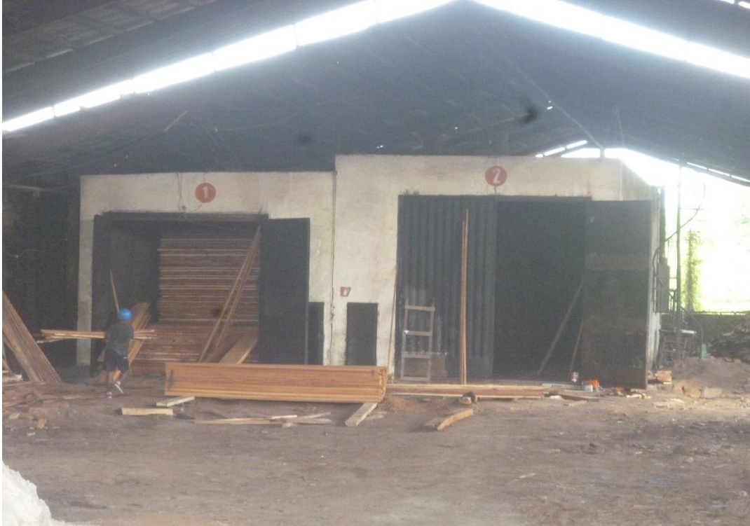
Foto 09. Cámara de secado en la industria Foreber SAC.
