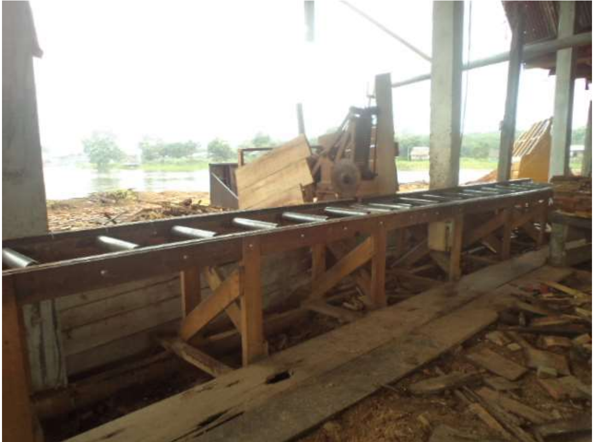
Figura 03: Despuntadora con sistema de rodillos de la empresa SICO MADERAS SAC
