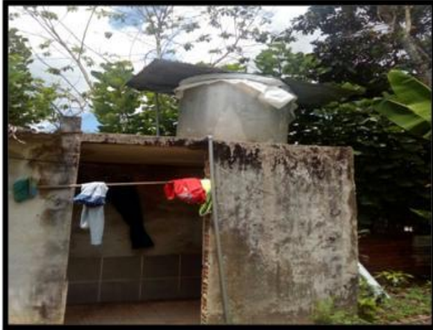
Imagen 07. Pozo de suelo con bombeo a tanque elevado.
