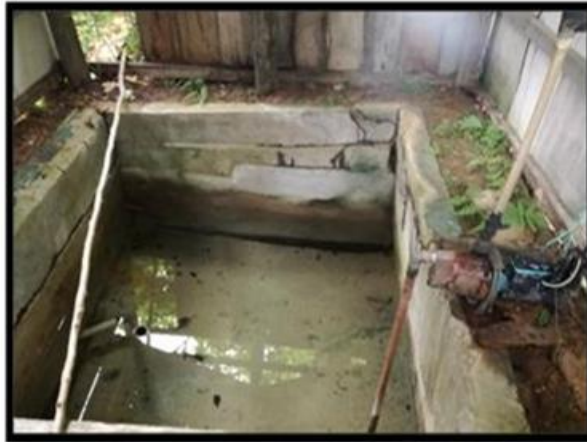
Imagen 5. Pozo abierto con carga por escorrentía y extracción con bomba eléctrica.
